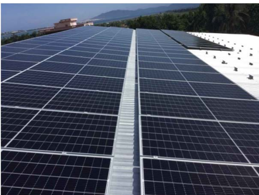
Les panneaux solaires de l'atelier d'embouteillage
